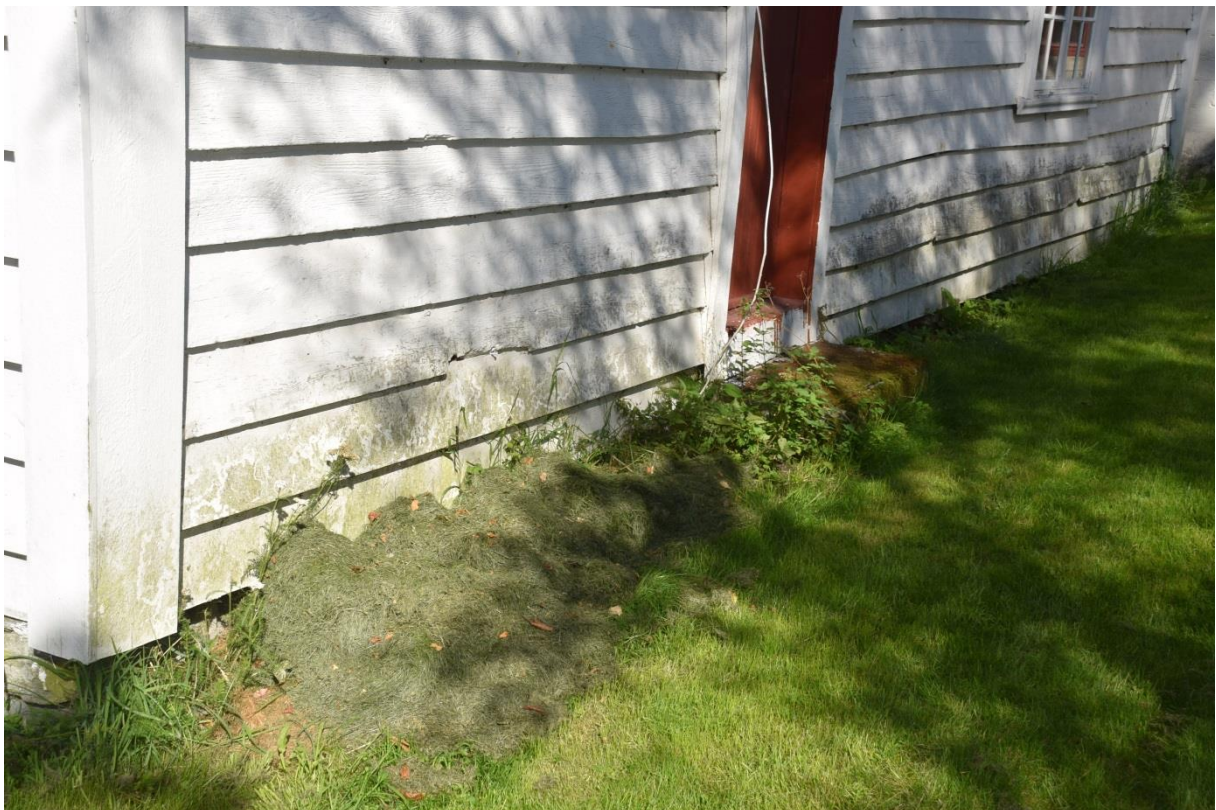
Baksida er prega av vegetasjon og uvettig dumping av gras inn mot kledningen. Dette har ført til algevekst og rote.
